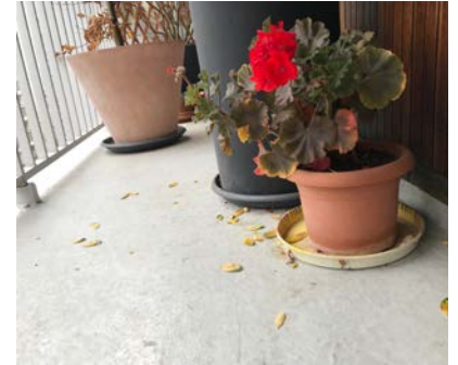
sol béton + résine + pas de gouttières
